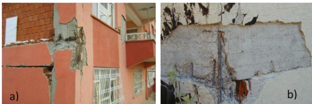
Figura 10 - Estrutura danificada devido a espaçamento inadequado entre reforços de cisalhamento durante (a) terremoto de Van e (b) terremoto de Bingöl. [19]
