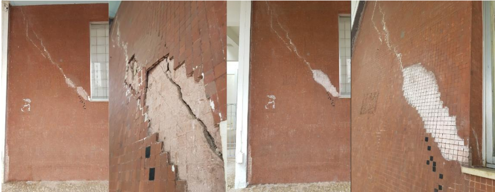
Figura 5: Rachadura em 45°. Da esquerda para a direita: 2021; 2021; 2023; 2023; 2023; 2023.
