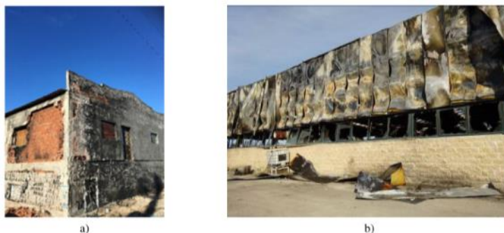
Figura 1: Análise de danos em paredes de fachada a) Destacamento e spalling de paredes de alvenaria b) Instabilidades e distorções de painel sanduíche com núcleo interno de PUR
