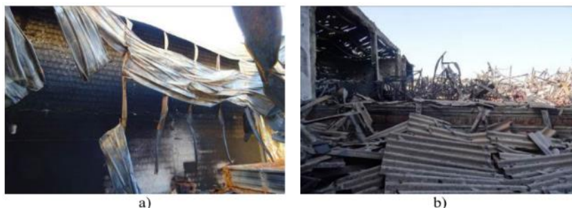
Figura 6: Análise de danos na cobertura [10]
