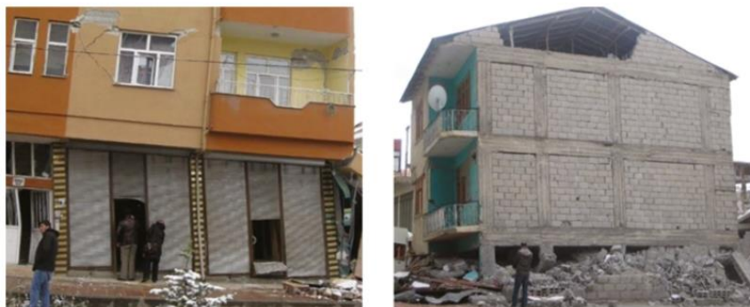
Figura 9 - Desvio entre andares inesperado devido ao piso mole durante o terremoto de Van. [19]
