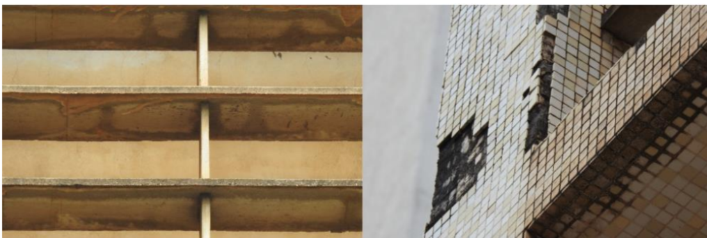
Figura 7: Lixiviação, sujidades, deslocamento e lodo (2023).
