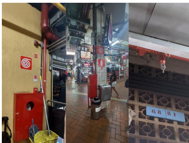
Figura 23: Equipamentos de prevenção e combate a incêndios
