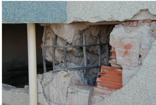
Figura 11 - Danos de colunas curtas durante o terremoto de Bingöl em 2003. [19]
