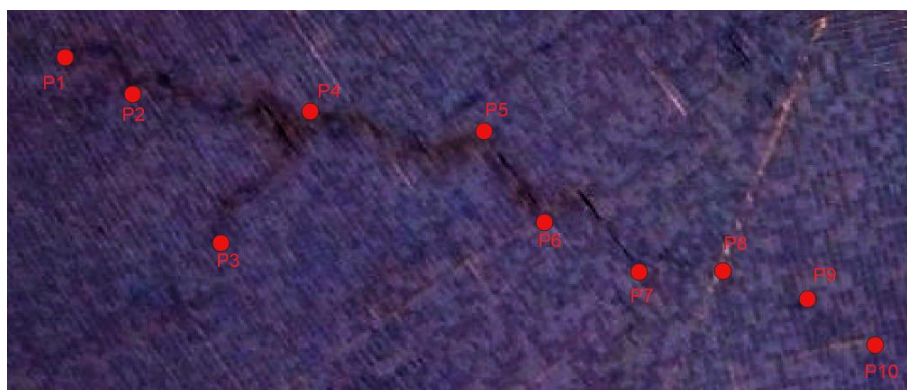
Figura 5 –Marcação de pontos de coordenadas nas extremidades da fissura. Fonte: autores
