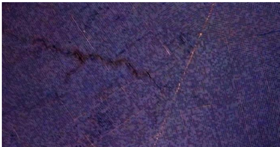
Figura 4– Detalhe da fissura após a geração da ortofoto. Fonte: autores
